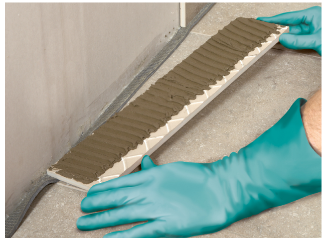
Die Sockelfliesen werden mit rückseitig aufgetragenem Verlegemörtel verklebt. Der Randdämmstreifen muss zwischen Sockelfliese und Bodenfliese heraussehen...
