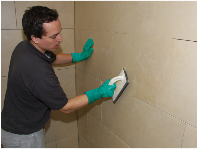
Verfugung der Fläche mit einer Sopro Fugenmasse (z.B. Sopro DF 10 DesignFuge Flex, Sopro Brillant Perlfuge)
