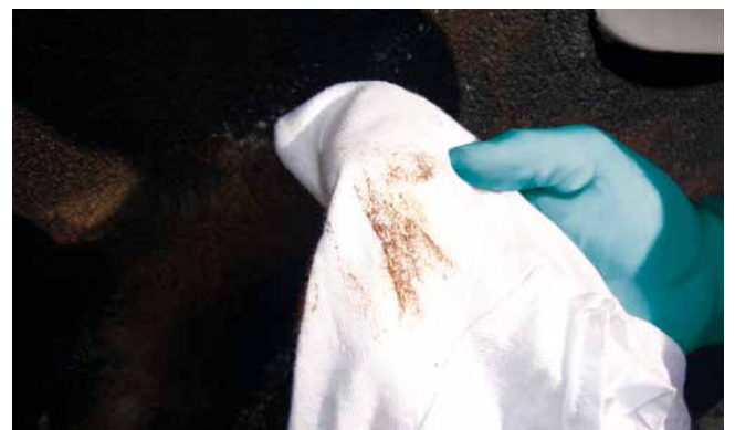
Braunfärbung: Die Fläche läßt sich anlösen. Es handelt sich mit sehr hoher Sicherheit um einen Bitumenanstrich. Die Fläche ist nach Reinigung (Entfernung von Schmutz und Erde) mit Bitumen-Dickbeschichtung, z. B. Sopro KellerDicht Super*, überarbeit- und abdichtbar.
