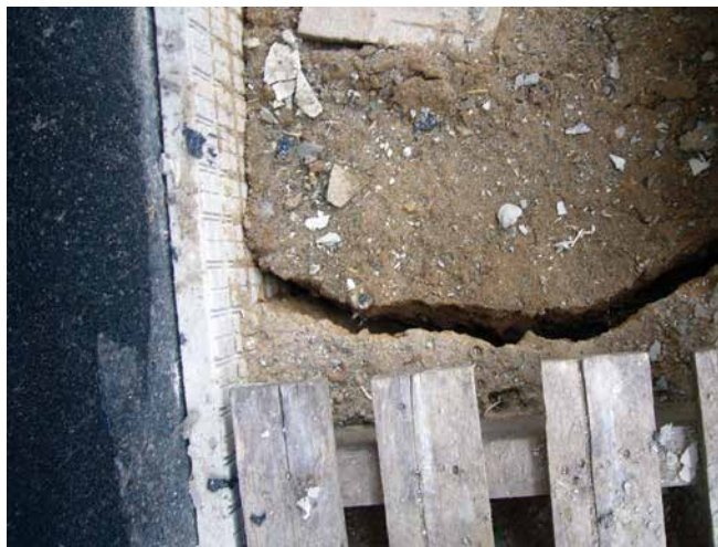
Große Setzungen aufgrund falscher Befüll- und Verdichtungsarbeiten. Wegen der fehlenden Gleitfolie ist eine Schädigung der Abdichtung vorprogrammiert.
