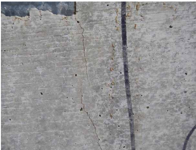
Rissbildungen in einer abzudichtenden Wand.
