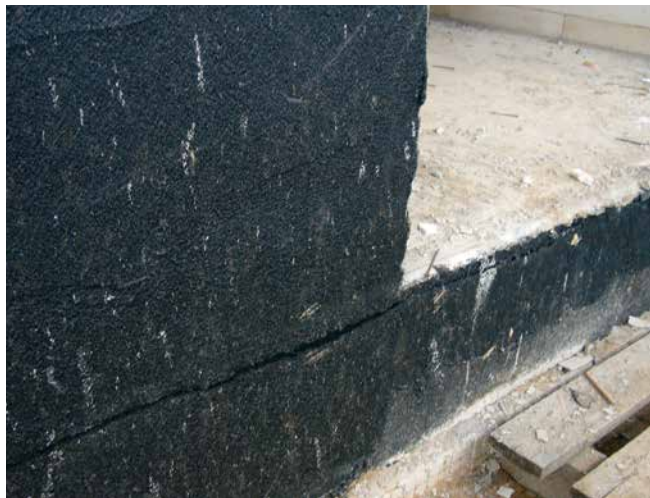
Abriss der Abdichtung aufgrund fehlender Gleitlagerfläche zwischen Abdichtung und setzendem Erdreich.
