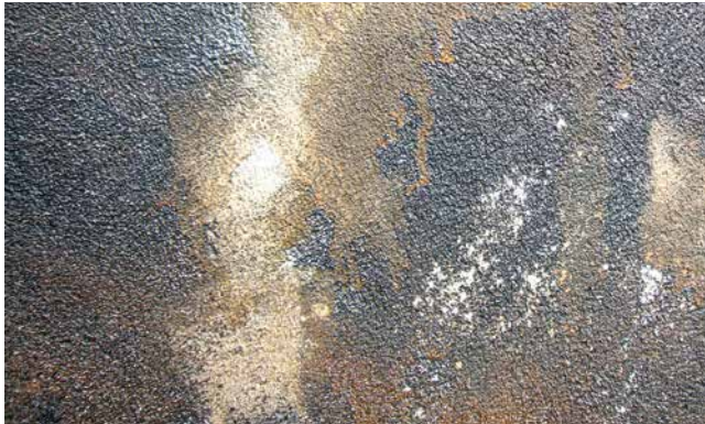
Alte freigelegte Kellerabdichtung.
