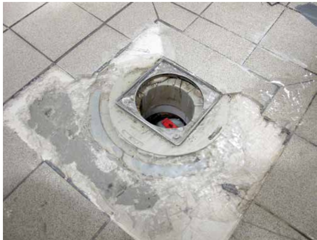
Werkseitig montierter Dichtflansch wurde, weil er störte abgeschnitten. Die Folge: Keine Anschlussmöglichkeit zur Dichtungsschlämme mehr möglich.
