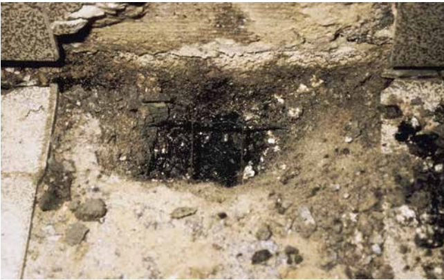
Durchfeuchteter Estrich wegen fehlender Verbundabdichtung – Hygiene-problematik z. B. in Großküchen.
