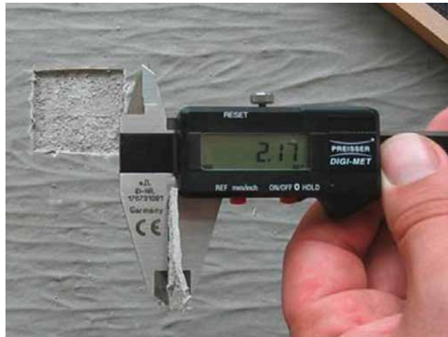
Die Schichtdickenmessung einer Ausbauprobe mittels Schieblehre. Bei W3-I sind die Kontrollen zu dokumentieren.
