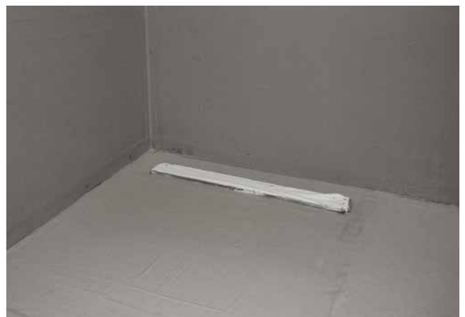
6 Komplet abgedichtete Duschecke in zwei Arbeitsgängen (Wand- und Bodenfläche) mit Sopro DichtSchlämme Flex 1-K, bereit für die folgende Fliesenverlegung.
