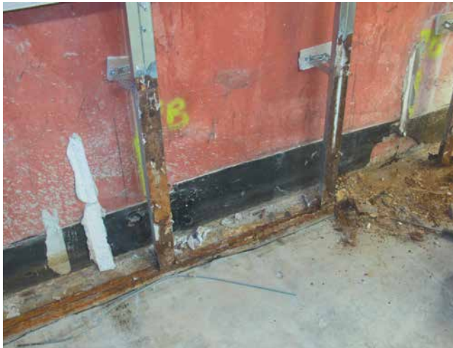
Zerstörung der Trockenbaukonstruktion, verursacht durch eingetragenes Wasser.
