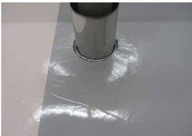
5 Mittels Sopro FlächenDicht Kontrastfarbe lässt sich die zweite Schicht Sopro PU-FlächenDicht einfärben. Das Arbeiten wird durch diese Sichtkontrolle erleichtert.
