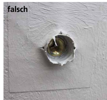
falsch Nach dem Herausdrehen des Baustopfens für die folgende Installation hat die Dichtmanschette ihre abdichtende Wirkung völlig verloren.
