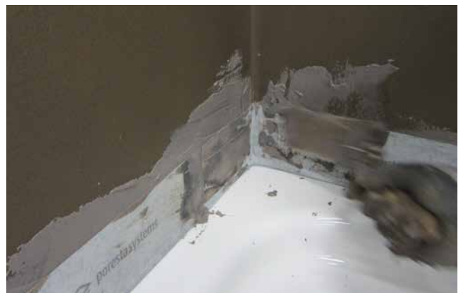
2 Die Dichtecke lässt sich z. B. mittels Sopro DichtSchlämme Flex 1-K leicht in der Raumecke einarbeiten.
