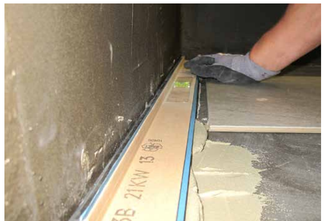
6 Einbau einer Wassersammelschiene, elastisch zur Wand gelagert, am Boden mit Fliesenkleber (Sopro's No. 1 S1 Flexkleber) verklebt.
