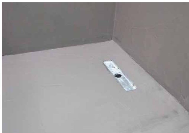
4 Mit Sopro DichtSchlämme Flex 1-K abgedichtete Duschcke, bereit für die folgende Fliesenverlegung.
