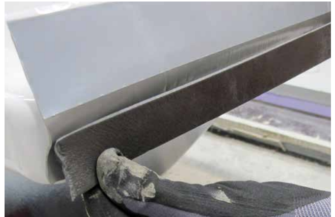
2 Ankleben eines Schaumstoffstreifens zur Vermeidung von Schallbrücken bei der Montage der Badewanne.
