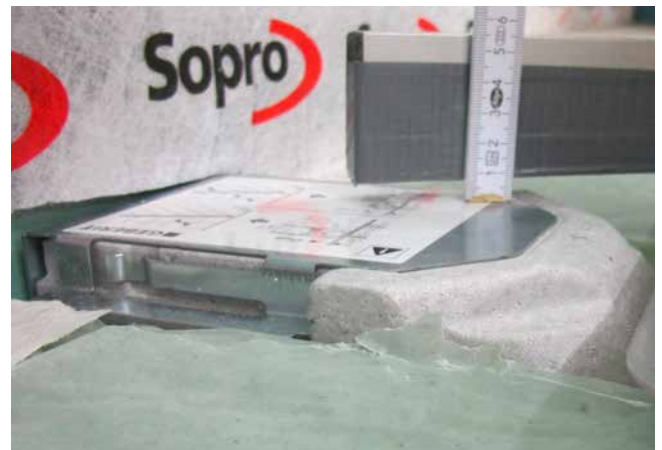
2 Die Estrichüberdeckungen sind partiell sehr dünn.
