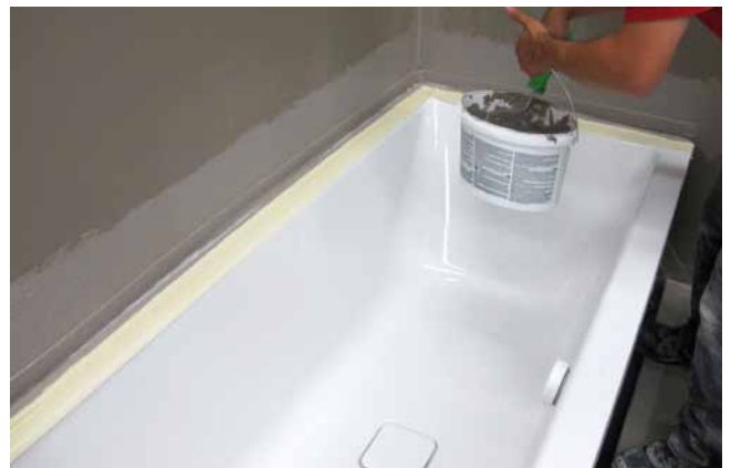
4 Eindichten des Wannenabdichtbandes (System MEPA – Pauli und Menden GmbH) mit Sopro FlächenDicht flexibel im Wandbereich.
