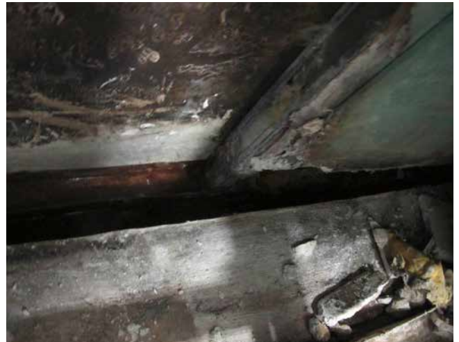
Schimmelbefall in einer Trockenbaukonstruktion mit Gipskarton.
