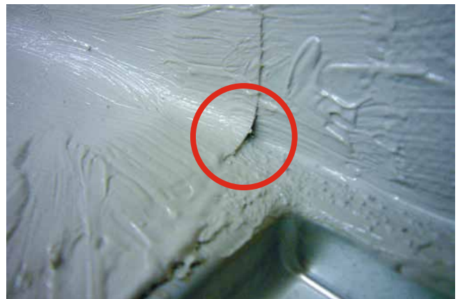
Eine Kanalbildung ist trotz Abdichtarbeit zu erkennen.
