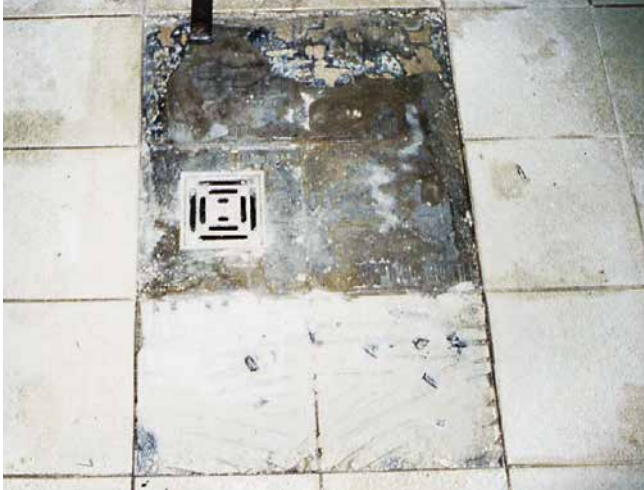
Fehlende Anschlussmöglichkeit der Verbundabdichtung an das Aufstockelement des Bodenablaufes.
