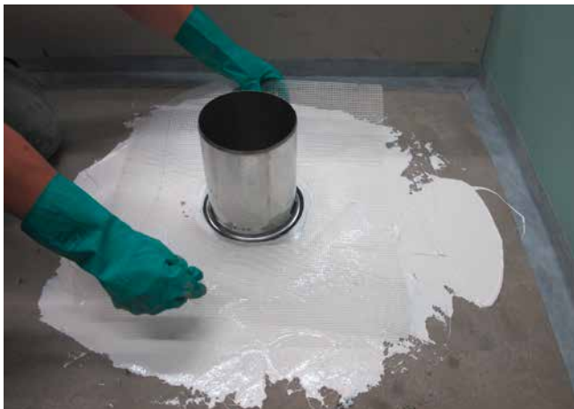
3 Das Hüllrohr wird nach den Grundierarbeiten mit Sopro Epoxi-Grundierung und der Quarzsandabstreung mit Sopro PU-FlächenDicht abgedichtet. Im Bereich der Durchdringung wird die Abdichtung durch eine Gewebeeinlage verstärkt.
