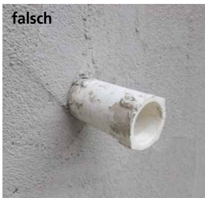
falsch Eingeputzter Baustopfen, an welchem man nicht fachgerecht andichten kann.
