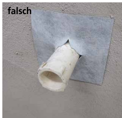
falsch Die Dichtmanschette wurde eingeschnitten, um sie über den Baustopfen stülpen zu können.
