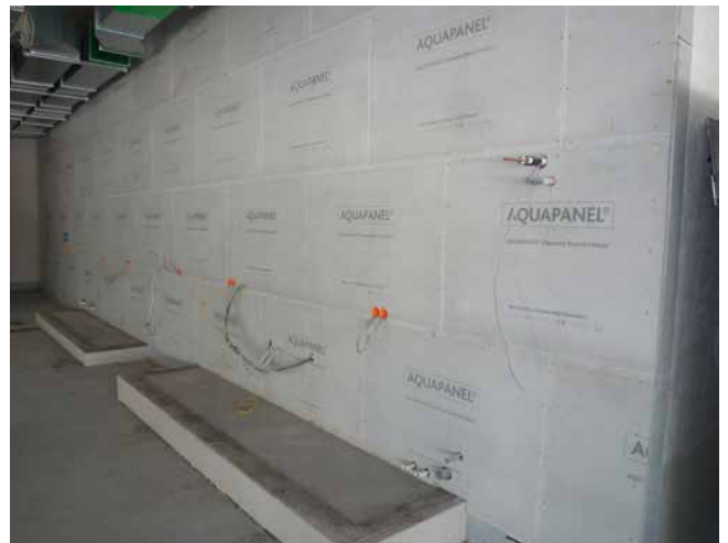
Zementgebundene Trockenbauplatten im Großküchenbereich.
