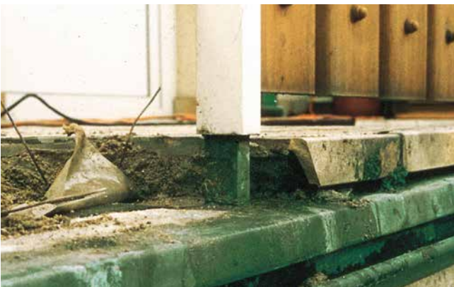
Calzitische Ablagerung im Bereich Rinne und Rinnenblech verursacht durch ungeschützten Estrich.
