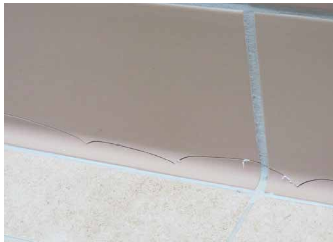
Hohlkehlsockelfliese mit dem langen Schenkel an der Wand verlegt, führt schnell zu Brüchen im unteren Bereich der Fliese.
