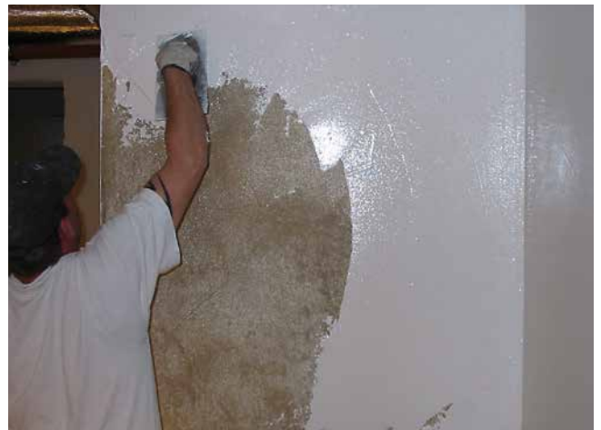
4 Applikation von Sopro PU-FlächenDicht an der Wand in zwei Arbeitsgängen – Gesamtmindestschichtdicke 1 mm.
