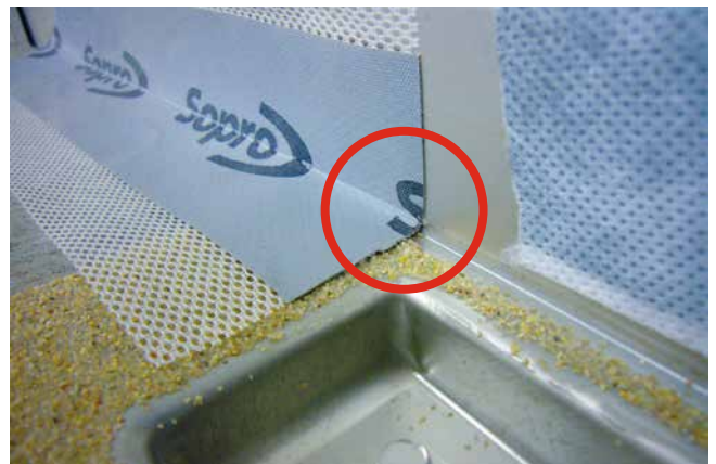
Dichtband liegt sehr gut auf den Stahlflächen auf.
