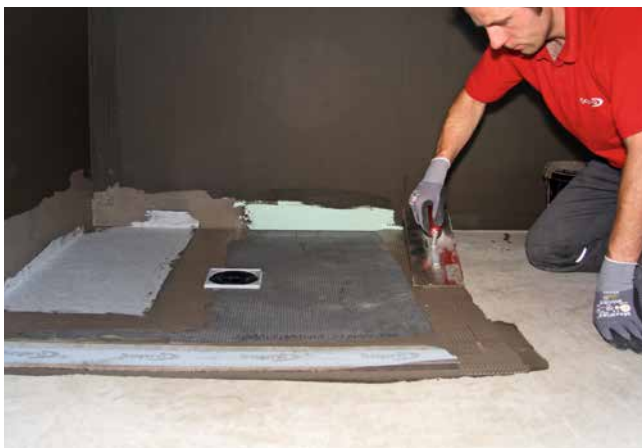
5 Abdichten der Fläche mit Sopro TurboDichtSchlämme 2-K und Dichtbändern sowie konfektionierten Dichtbahnstücken.
