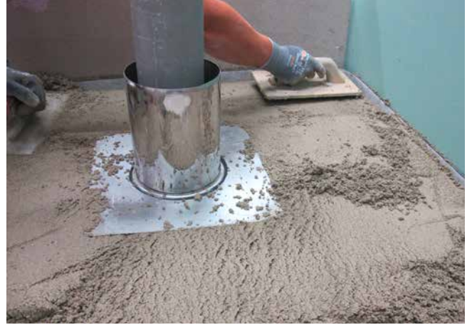
2 Einbau des lastverteilenden Zementestrichs mit dem zweiten Hüllrohr, welches im Estrich fixiert ist und Hüllrohr 1 umschließt.
