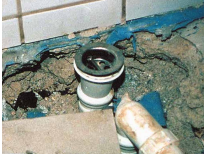
Undichtigkeit eines Tauchbeckens durch falschen Bodenablauf (Waschbeckenablauf). Flansch für die Flächenabdichtung fehlt.
