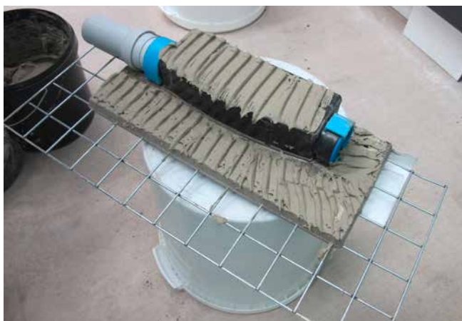
1 Abspachteln des Dallmer Bodenablaufelementes mit Sopro's No. 1 S1 Flexkleber für einen guten Haftverbund zum Estrichmörtel.
