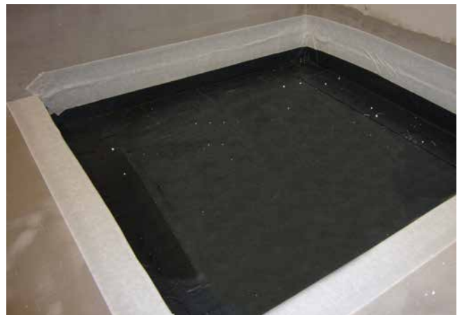
6 Mit SoproThene® Bitumen-Abdichtungsbahn abgedichtete Duschecke, überklebt mit SoproThene® Abschlussband Vlies zum Anschluss für die folgende Verbundabdichtung.
