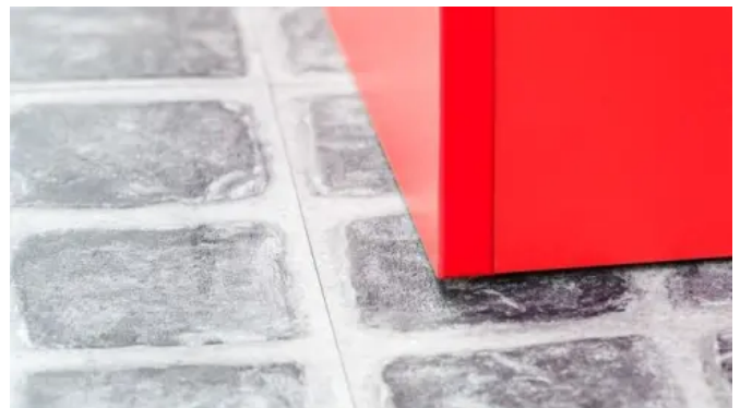
Mit dem Trockenklebstoff SIGAN ELEMENTS PLUS in Kombination mit der Stabilisierungsunterlage UZIN RR 185 konnte der neue Bodenbelag schnell und unkompliziert verlegt werden.
