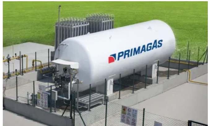
LNG ist die optimale Lösung für industrielle Anwendungen mit extrem hohen Energieverbräuchen, z.B. Dämpfen, Trocknen, Backen etc.
