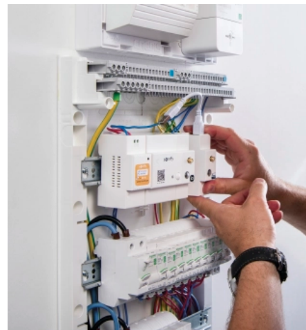
TaHoma® DIN rail im Schaltschrank
