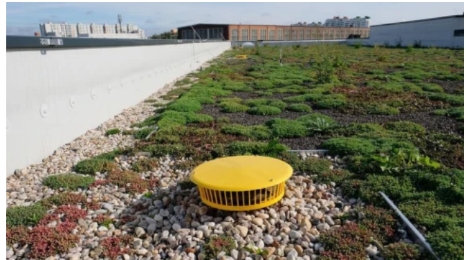
Die Anschlussbauteile des Retentionsdaches sind zur vereinfachten Revision in einem Kiesbett platziert.
