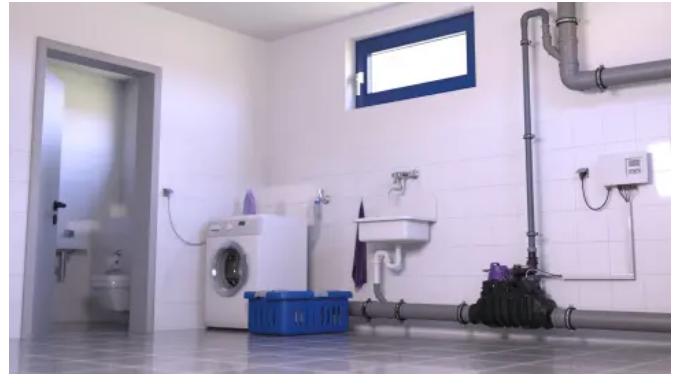
Ecolift Rückstauhebeanlage in eine freiliegende Abwasserleitung eingebaut
