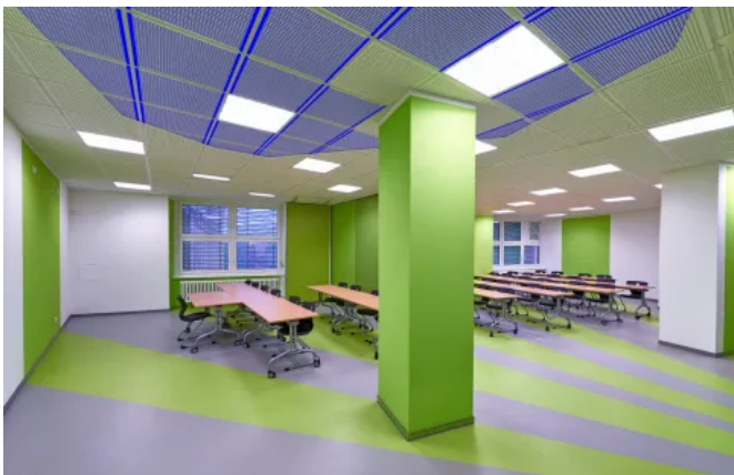
Darstellung einer Rasterdecke mit vorgefertigten Gipskartonkassetten mit integrierten Kapillarrohrrmatten am Beispiel eines Schulungsraumes der SHK Innung Berlin ©Clina Heiz- und Kühlelemente GmbH
