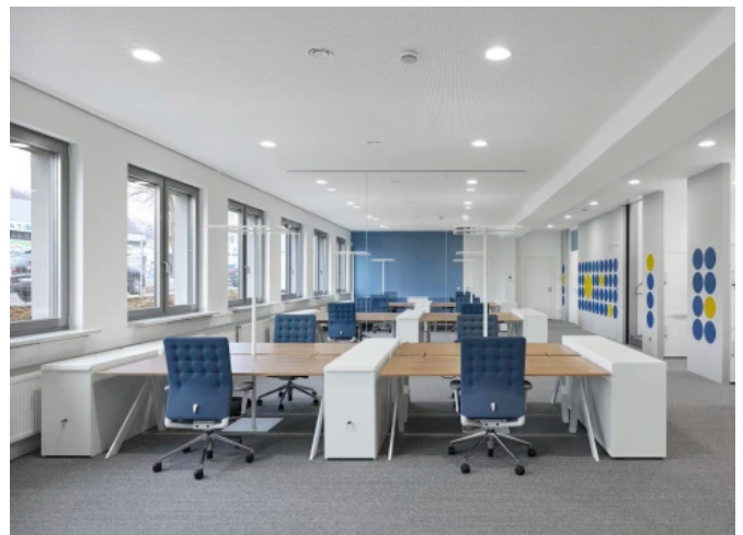
Fertiggestellte Gipskartondecke mit OPTIPANEL 18 als Heiz- und Kühldecke im Bürogebäude Haecker Metall Pforzheim © Roland Halbe
