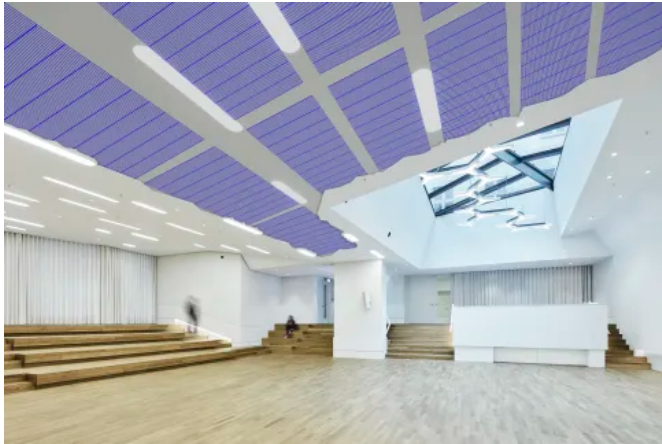
Darstellung der Kapillarrohrmatten Typ OPTIMAT eingeputzt an einer Gipskartondecke im Hörsaal der Psychologischen Hochschule Berlin © a-base büro für architektur, Foto: Klaus Romberg
