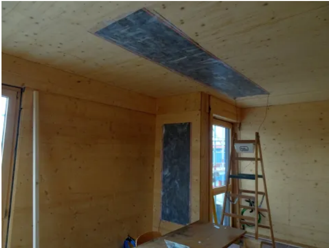
Infrarotheizung an Wand und Decke
