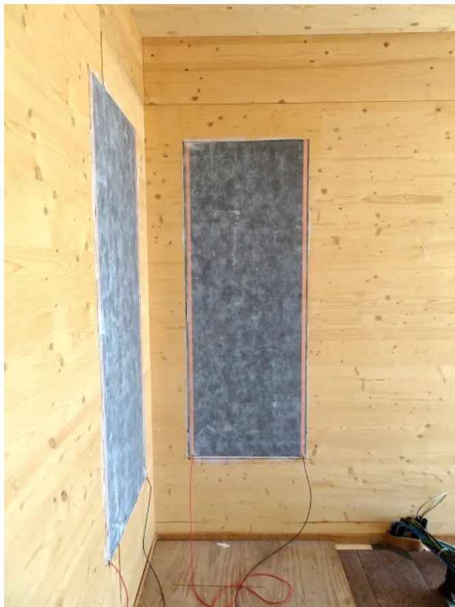
Infrarotheizung an Wand
