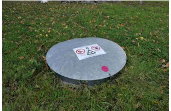
unterirdisch eingelagerten Behälter
