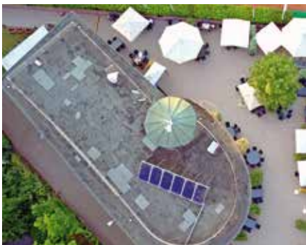
Das Dach des KETV als „nacktes“ Bitumendach vor der Neugestaltung zu einem Gründach.
