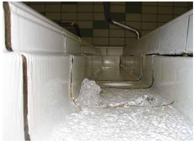
Poröser Fugenmörtel; das unter Druck stehende Wasser findet seinen Weg fontänenartig durch den Rinnenboden.
