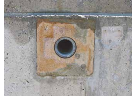
Holzplatte als Ausparung in einer Betonbeckenwand für die spätere kapillarbrechende Spachtelung oder die Montage eines Flansches.
