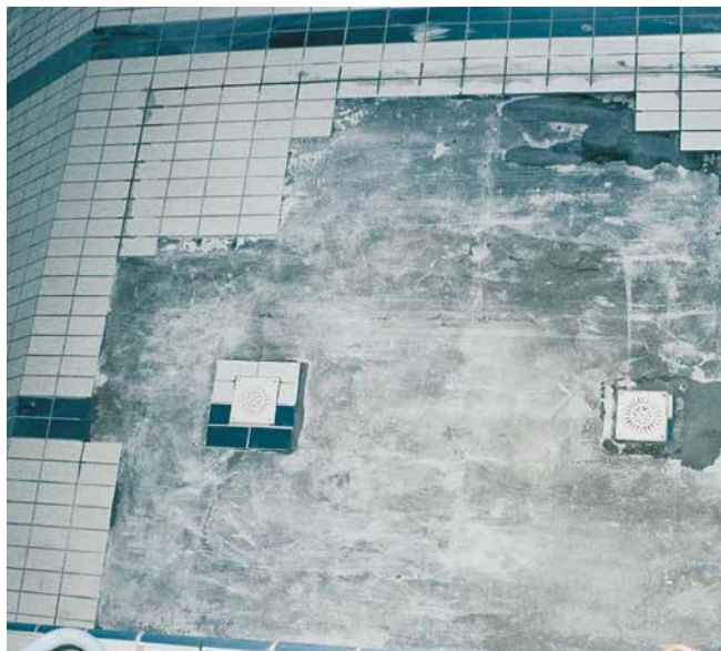
Haftverbundschaden durch Hinterwanderung der Abdichtung.
