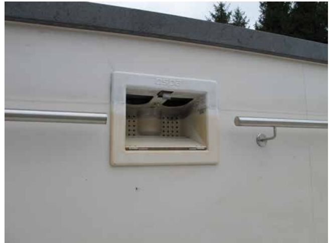
Schwimmbekken mit Skimmer.
