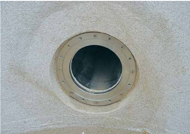
Vorbildlicher Anschluss einer Verbundabdichtung an ein Scheinwerfergehäuse im Unterwasserbereich mit Pressdichtflansch.
