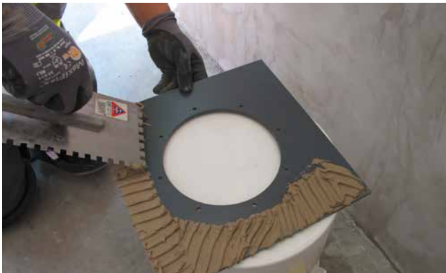
3 Rückseitiges Abspachteln der Flanschplatte mit einem Reaktionsharzmörtel (Sopro DünnBettEpoxi), um eine dauerhafte Bettung des Flansches zum Betonuntergrund zu schaffen.
