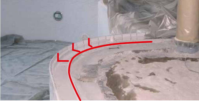
Nierenförmiges Becken mit schadhaftem Beckenkopf.
