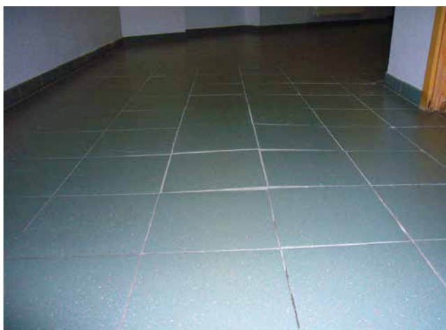
Gequollener Calciumsulfatestrich nach einem Wasserschaden.
