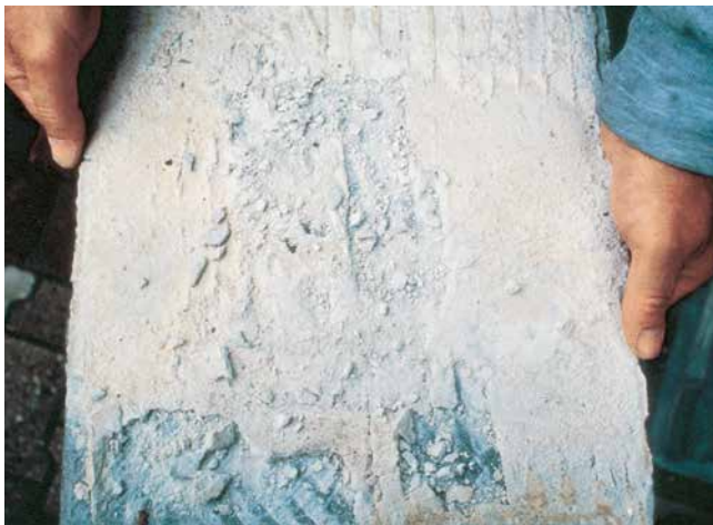
Haftverbundschaden durch Ettringitbildung.
