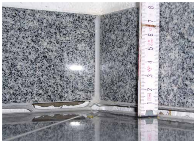
Silikonfugen werden bei Nichtbeachtung der Vorgaben durch die Verformungen im Estrich überdehnt und reißen ab.
