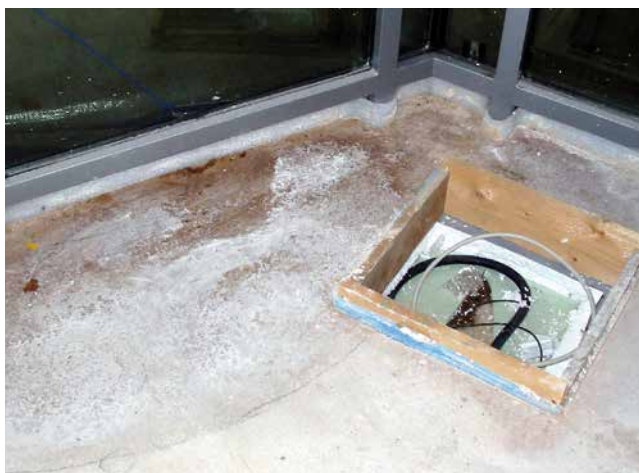
Festigkeitsprobleme und Auflösungserscheinungen des Calciumsulfatestrichs nach Wassereintritt.
