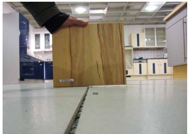
Verformung im Gussasphalt und keramischen Belag aufgrund von Temperatureinwirkung.
