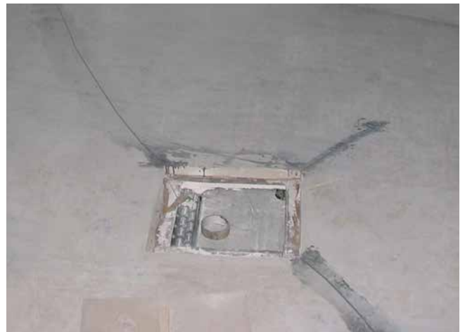
Rissbildung bei einem calciumsulfatgebundenen Estrich nach dem Trocknungsprozess an einem Bodentank.
